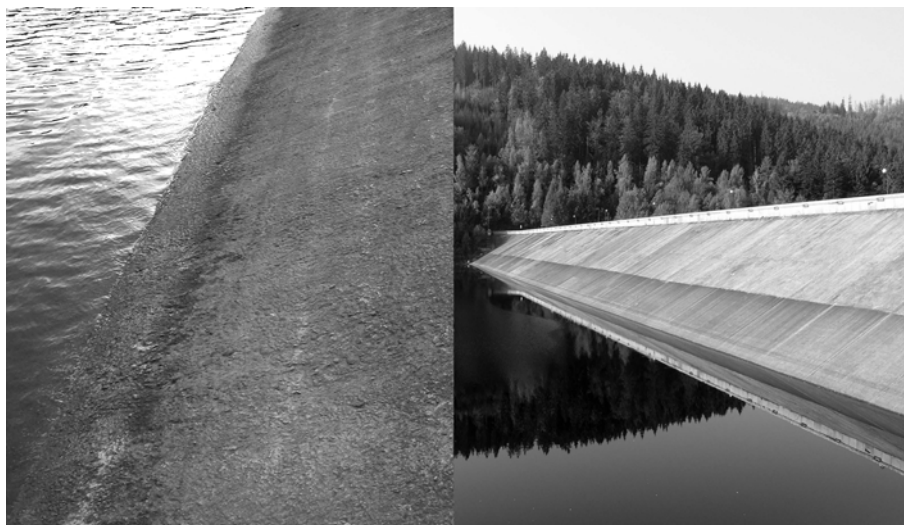
Rys. 8. Cienka warstwa zaprawy naprawczej tworząca zabezpieczenie powierzchni w strefie falowania po 8 latach od nałożenia
