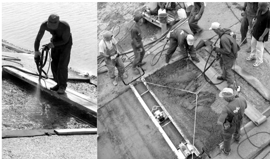
Rys. 10. Naprawa ekranu betonem: natrysk warstwy szepnej (z lewej), układanie mieszanki betonowej (z prawej)
