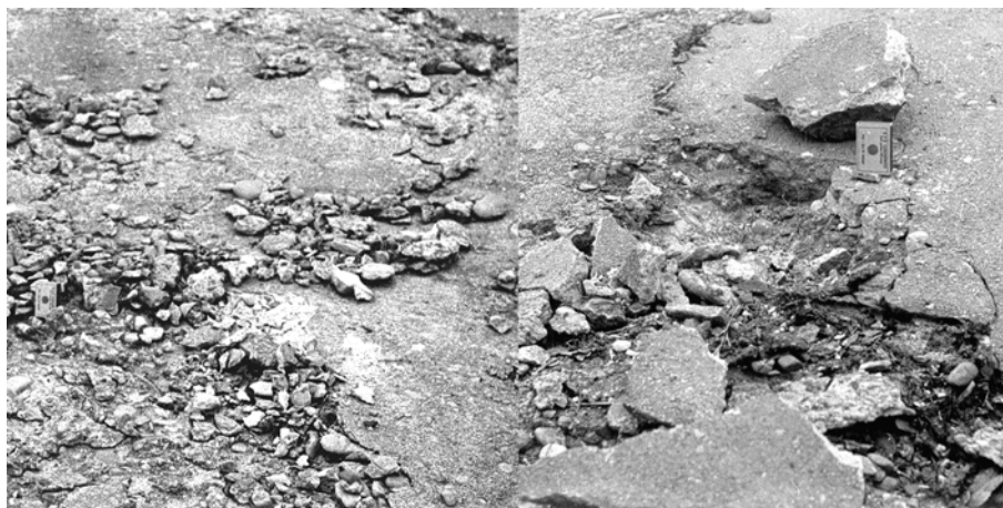
Rys. 1. Odspojone i zniszczone naprawy na skarpie zapory odwodnej (OLSZAMOWSKI i TEŻYCKI 2004)
