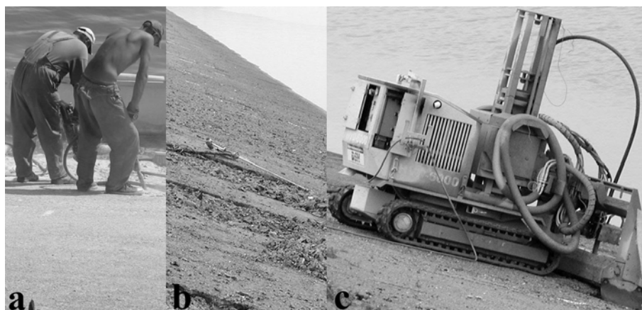
Rys. 3. Sprzęt i metody przygotowania powierzchni do naprawy: a – młotkowanie, b – skuwanie wodą pod ciśnieniem powyżej 1000 bar lancą ręczną, c – skuwanie robotem
